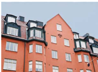
Ett 1910-talshus hade takkupor på nedre takfallet från början. Kupor också på övre takfallet påverkar upplevelsen av arkitekturen och minskar det kulturhistoriska värdet. Foto Ingrid Johansson.
