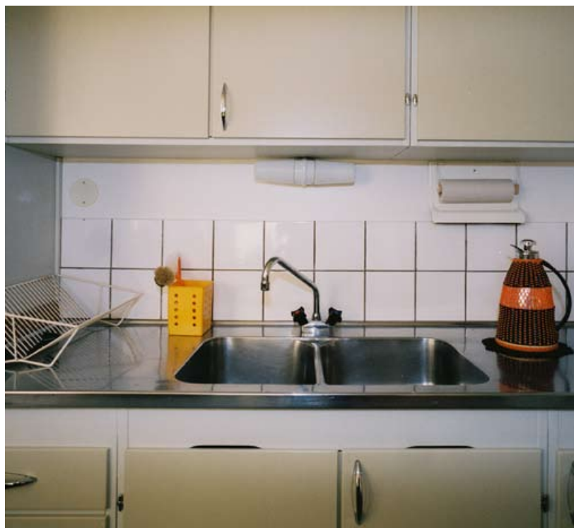
Diskbänk från 1960-talet med två hoar och två rader av kakel ovanför. Stadsmuseets museilägenhet i Tensta. Foto: Ingrid Johansson.
