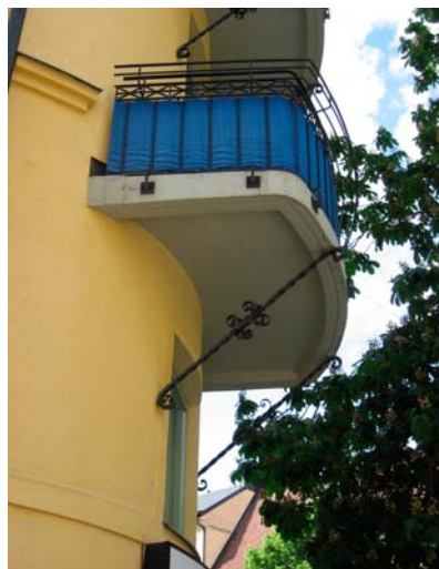
Bevarat jugenddräcke i Vasastaden. Den ursprungliga balkkonstruktionen har ersatts av en grov betongplatta som är främmande för husets karaktär. Foto Martin Lagergren.
