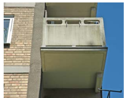
Bearbetat betongräcke på punkthus från 1950-talets mitt. Högdalen. Foto Göran Fredriksson.
