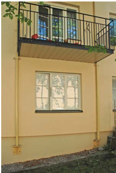
Skenorna är här neddragna på sockelmuren och försöket att måla in dem i fasadkulör har inte lyckats. Plattans undersida är olämpligt utformad i plåt. Treluftsfönster är inte lämpliga att bygga om till balkongdörrar. Foto Göran Fredriksson.
