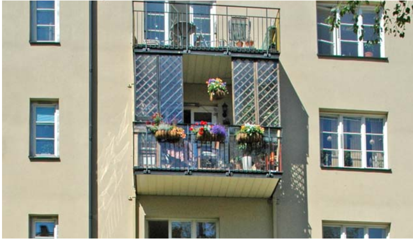
I öppet och väl synligt läge på Södermalm har balkonger monterats på stålskenor på fasaden. Monterings-sättet är inte varsamt mot husets karaktär. Endast två balkonger har monterats på denna fasad vilket än mer förftar byggnadens arkitektoniska uttryck. Foto Göran Fredriksson.
