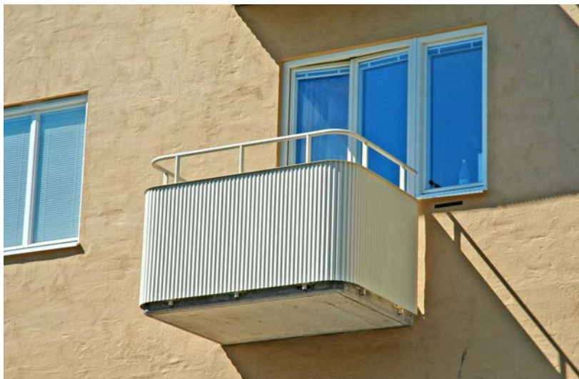
Smalhus på Södermalm där tidsenliga balkonger med betongplattor monterats utan synliga bäranordningar. Foto Göran Fredriksson.
