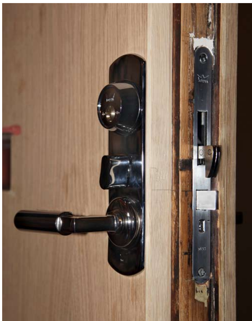
En förstärkt dörr med nytt hakregellås som tillsammans med bakkantsbeslag gör den omöjlig att lyfta av, Östermalm. Foto: Ingrid Johansson.
