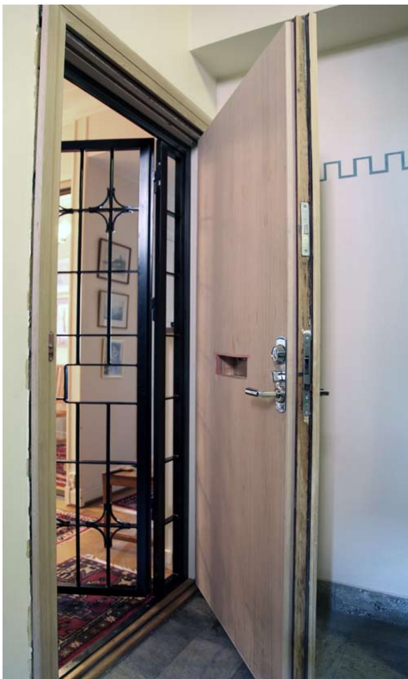
Slät lägenhetsdörr från 1930-talet som har förstärkts med en hel platta på dörrens insida. Östermalm. För att förstärka säkerheten ytterligare har en gallergrind monterats innanför dörren. Foto: Ingrid Johansson.
